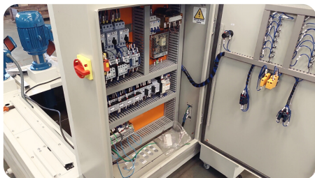
▲ Painéis de controle
